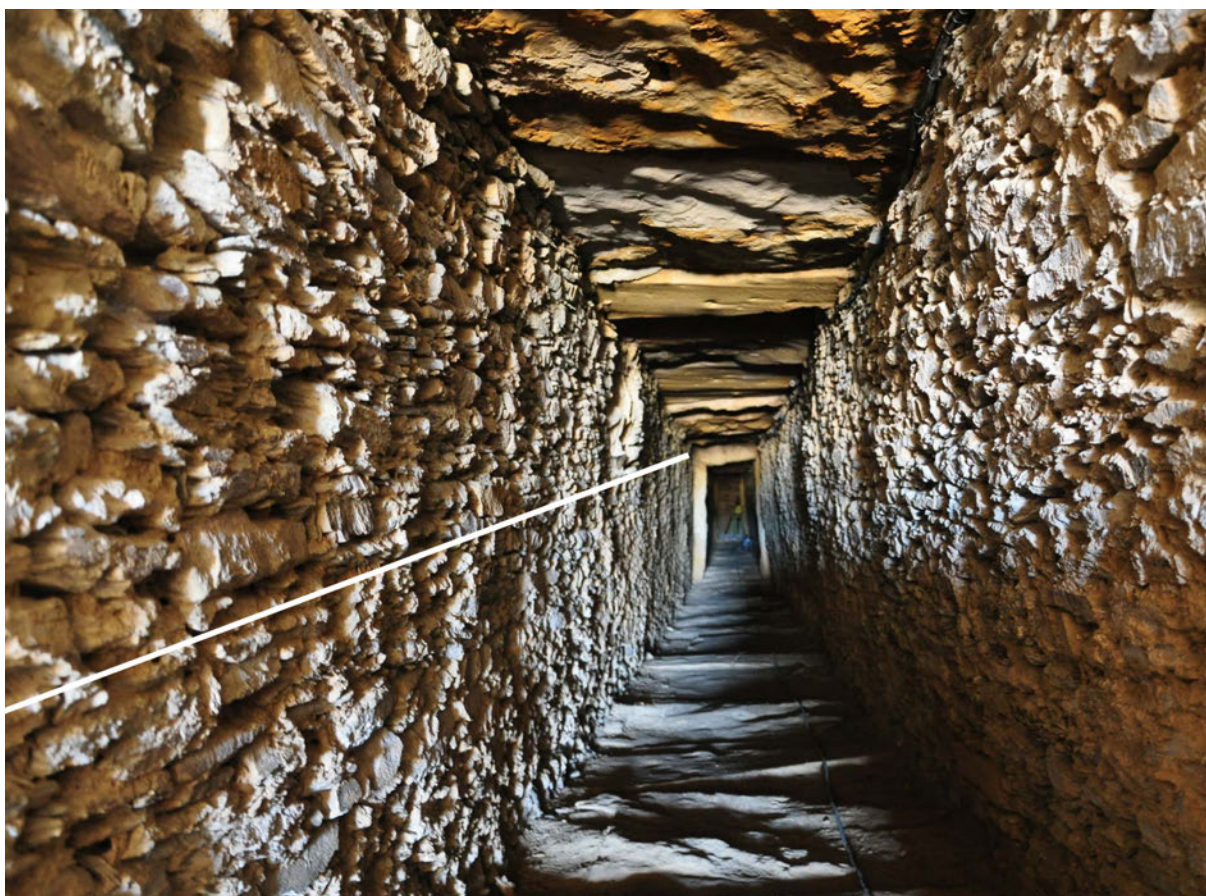
Figura 9. Interior del corredor con alineación oblicua de mampuestos dispuestos como refuerzo estructural.
