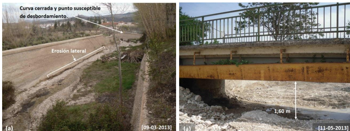
Figura 10. (a) Estado del río Chico al inicio del encauzamiento; (b) Puente peatonal y vano con capacidad de drenaje mermada por la acreción sedimentaria del lecho.
