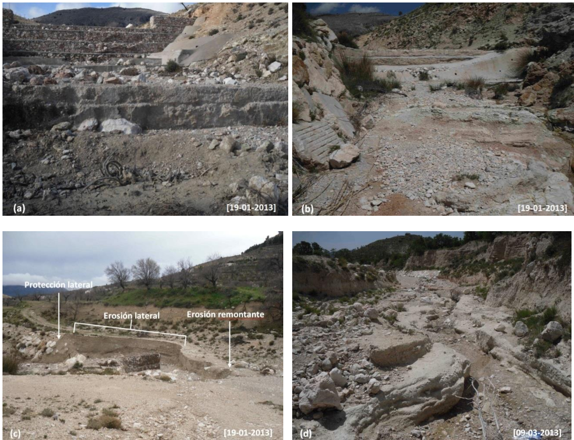
Figura 5. (a) Erosión local al pie del dique Dq1; (b) Acorazamiento estático granular del lecho entre los diques Dq1 y Dq2; (c) Erosión lateral con socavamiento y destrucción del dique Dq3; (d) Incisión y encajamiento del lecho aguas abajo del dique Dq4.
