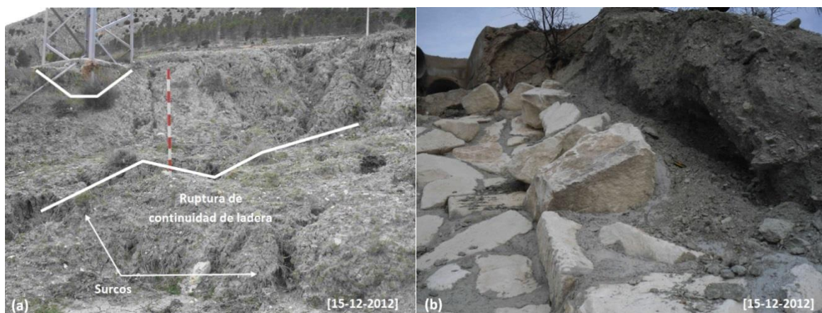
Figura 4. (a) Deslizamiento de ladera que afecta al margen derecho del cauce. (b) Incisión lateral en la parte superior de la escollera construida en el subtramo I1.
