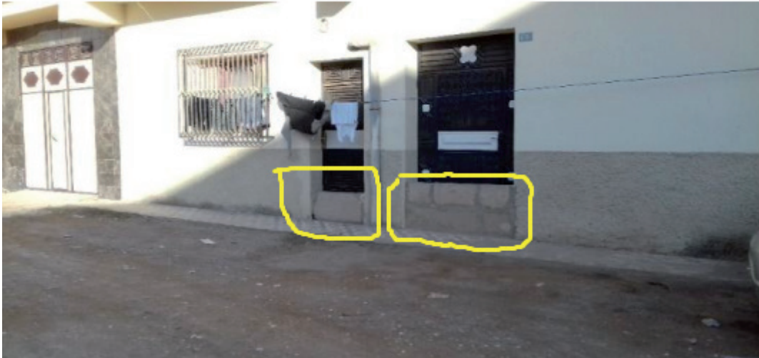
Photo 5. Des portes de maisons protégées avec des murettes en briques pour éviter l'inondation de l'intérieur, localisées au niveau du quartiers Elfid ville de Nador. Source: Auteurs.
