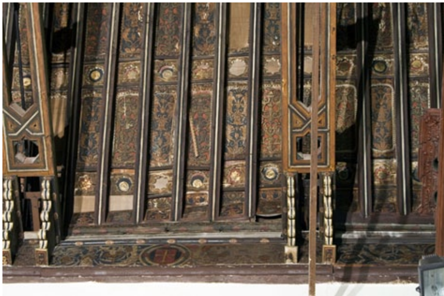
Fig. 2. Detalle de la armadura de la iglesia de Santa María del Socorro. Sevilla.
