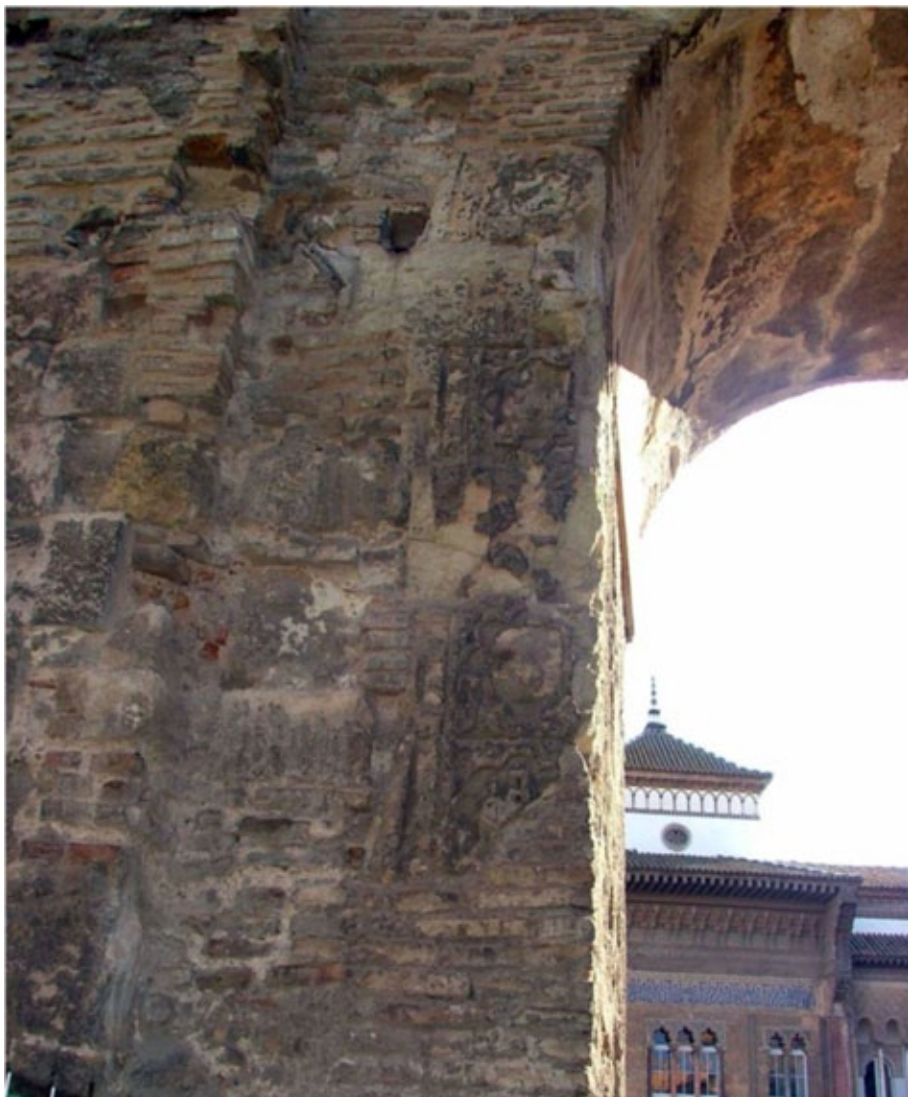
Fig. 7. Arco central del paramento León Montería. Jamba lateral con decoración in situ de motivos heráldicos en la que se intercala el León, la Banda y Castillo.
