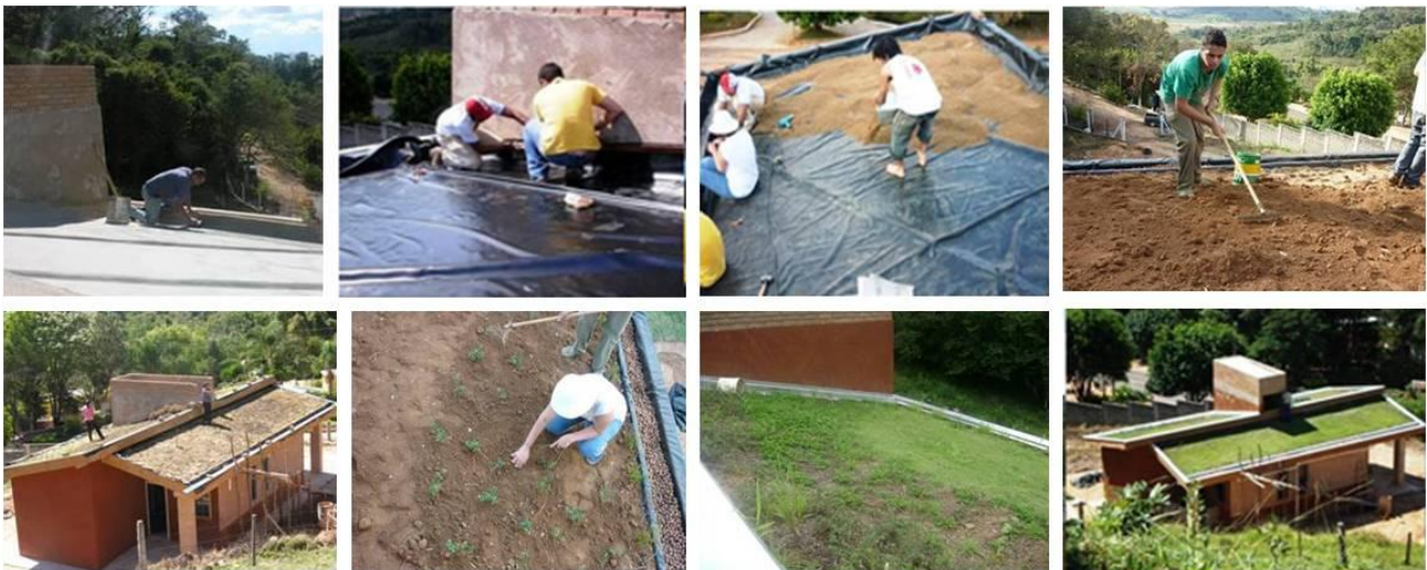
Figura 8: Processo de construção do teto verde: impermeabilização, colocação da terra e plantio da cobertura vegetal. Fonte: GEAHAS, 2009.
