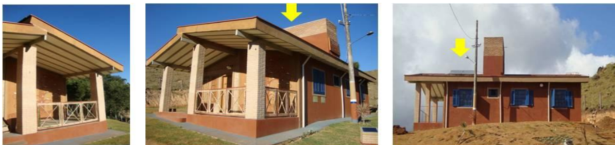
Figura 12: Coletor solar instalado na cobertura, com ângulo superior à latitude do local, e a torre construída para o reservatório térmico e o de água fria. Fonte: GEAHs, 2010.
